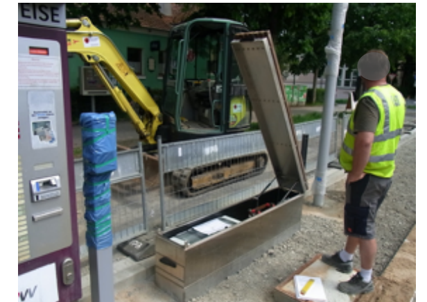
Schaltschrank und Techniksitzbank (Nürnberg, Würzburg)
